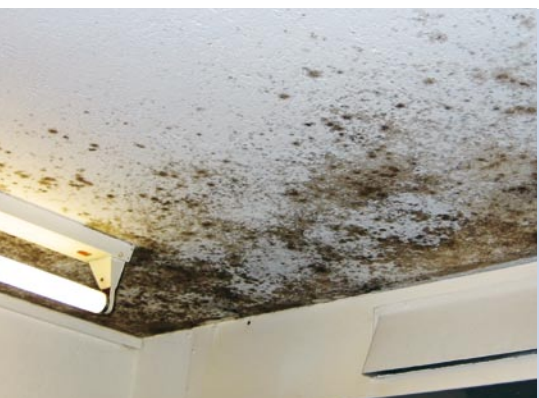
Wenn feuchte Luft auf kalten Wänden kondensiert, können sich Schimmelpilze ausbreiten.
